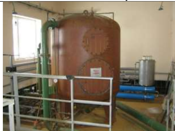
Рисунок 6.4.3.4 – Оборудование новой станции обезжелезивания в п.г.т. Сусанино
