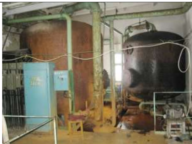
Рисунок 6.4.3.2 – Оборудование старой станции обезжелезивания в п.г.т. Сусанино
